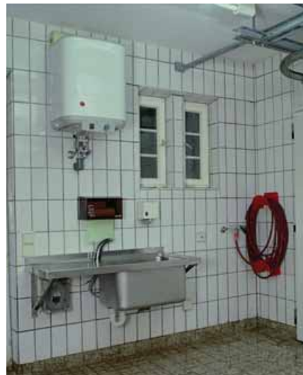
Im Optimalfall verfügt eine Wildkammer auch über einen Warm- und Kaltwasseranschluss.
